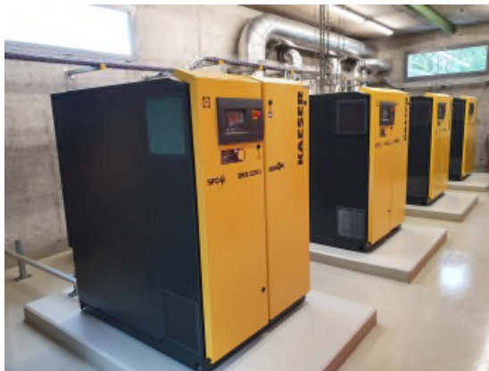
Die komplett erneuerte Gebläsestation
